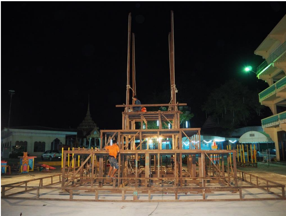
รูปภาพที่ 55 โครงสร้างส่วนฐานและเสาตัวเรือนของเมรุประธาณ
