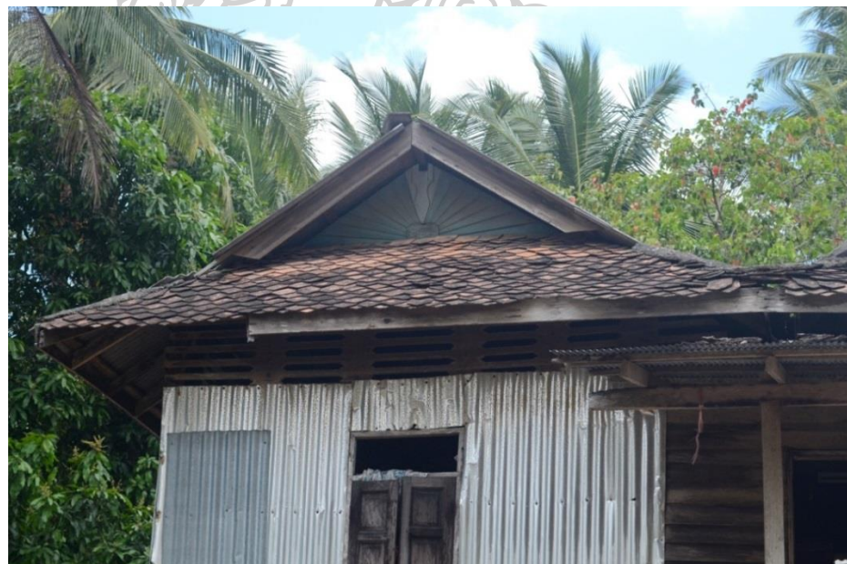
ภาพที่ 4 หลังคาจั่ว (แม่และ) ที่มา: แหล่งข้อมูลภาพถ่าย ในเขตหมู่ 2 และ 4 หมู่บ้านภูมิน้ำพุ่ง ตำบลยามู อำเภอยะหริ่ง จังหวัดปัตตานี, ภาพถ่ายเมื่อวันที่ 25 มิถุนายน 2558
