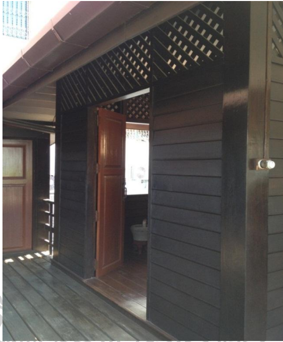
ภาพที่ 64 แสดงผนังเรือนไทยพุทธธำมรงค์ ผนังไม้ตีตามนอนซ้อนเกล็ด
