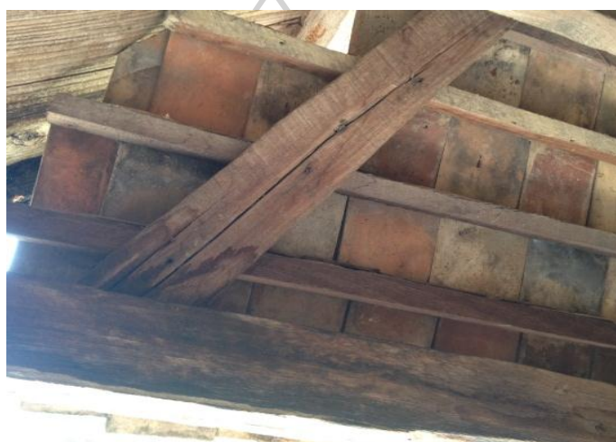
ภาพที่ 45 แสดงกระเบื้องหลังคาดินเผาขนาดเล็กบาง มุงซ้อนกันสองชั้น
