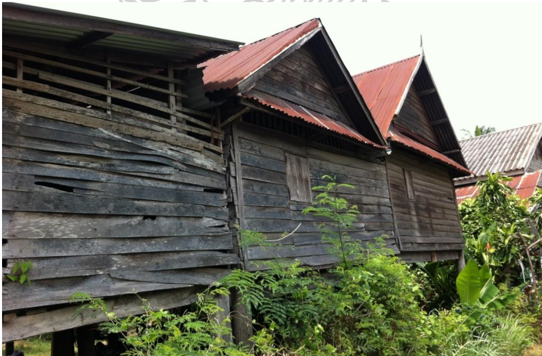
ภาพที่ ก-18 แสดงมุมมองด้านหลังเรือนกรณีศึกษาที่ 4 (ภาพถ่ายในปี พ.ศ.2556) ก่อนที่ไม้ป้านลมจะหลุดออกไปทั้งหมด
