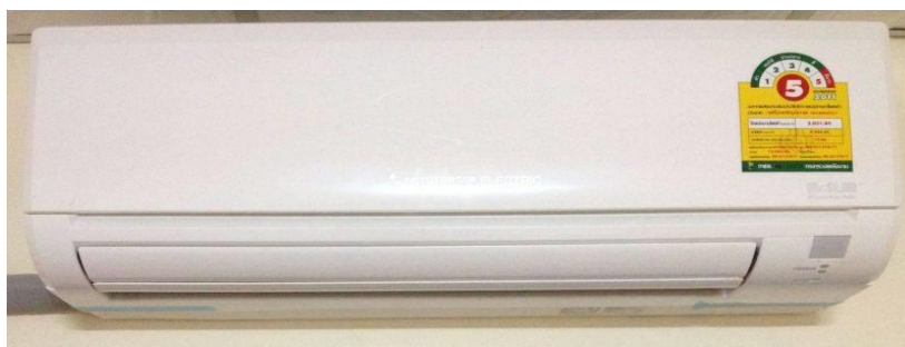
รูปที่ 3.11 เครื่องปรับอากาศของห้องทดลองที่ 2
