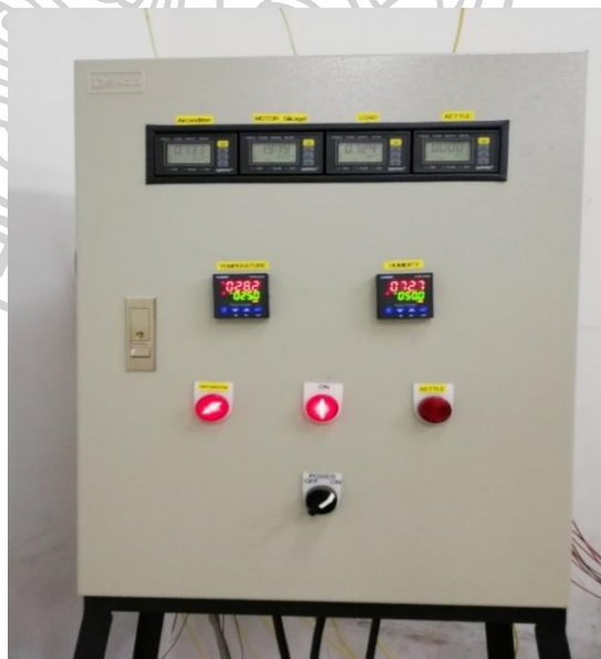
รูปที่ 3.15 ตู้ควบคุมของห้องทดลองที่ 1
