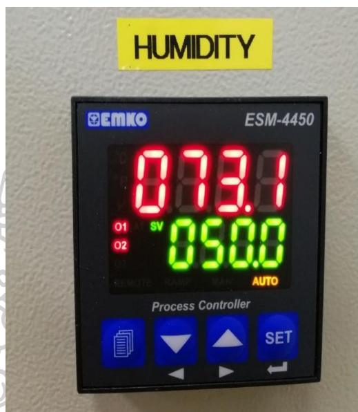
รูปที่ 3.18 อุปกรณ์ควบคุมความชื้น รุ่น ESM-4450
