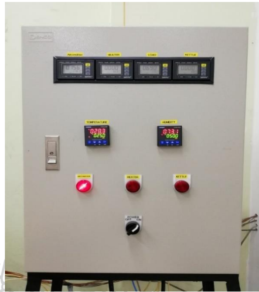
รูปที่ 3.16 ตู้ควบคุมของห้องทดลองที่ 2
