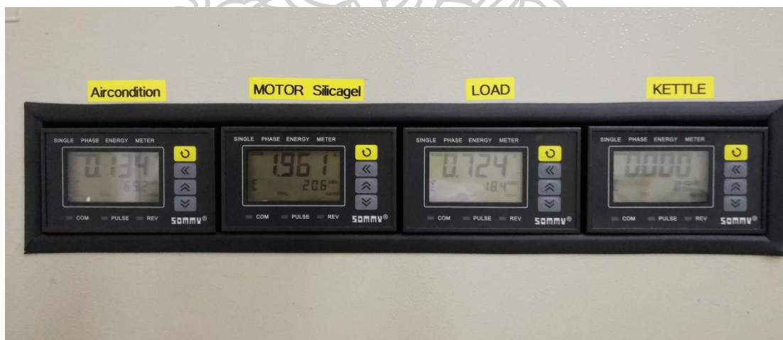
รูปที่ 3.22 อุปกรณ์วัดการใช้พลังงานของห้องทดลองที่ 2
