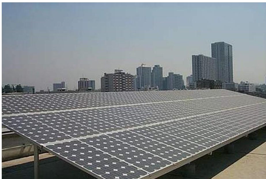
รูปที่ 2.3 เซลล์แสงอาทิตย์ที่ติดตั้งบนอาคารสำนักงานคณะกรรมการนโยบายพลังงานแห่งชาติ [13]
