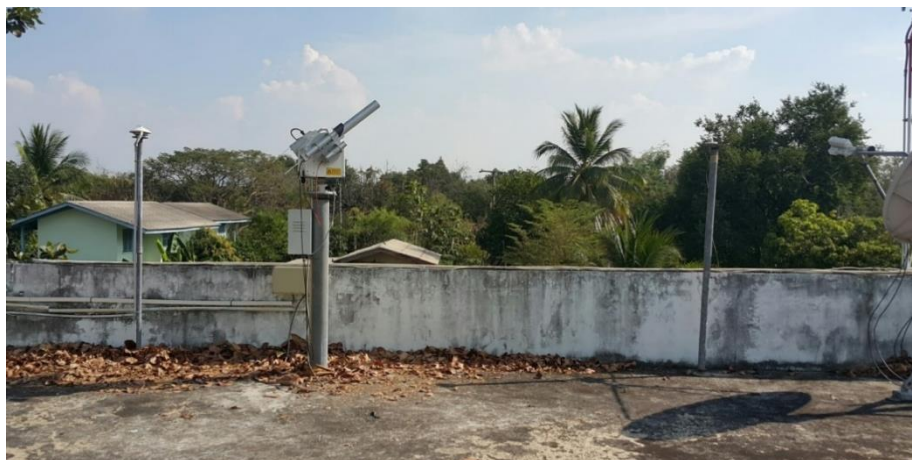
รูปที่ 50 เครื่องมือที่ประยุกต์ขึ้นติดตั้งบนคานาดฟ้าของสถานีลพบุรี
