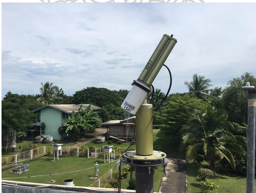
รูปที่ 39 เครื่องชั้นโฟโตมิเตอร์ที่ติดตั้งที่สถานีลพบุรี
