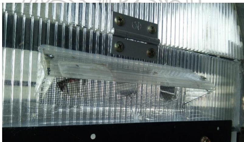
รูปที่ 42 ช่องอากาศเข้าที่ปิดด้วยตาข่ายกันแมลง และกันสาดป้องกันน้ำ
