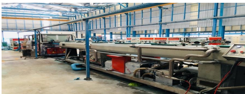
ภาพที่ 13 ระบบหล่อเย็น (Cooling)
