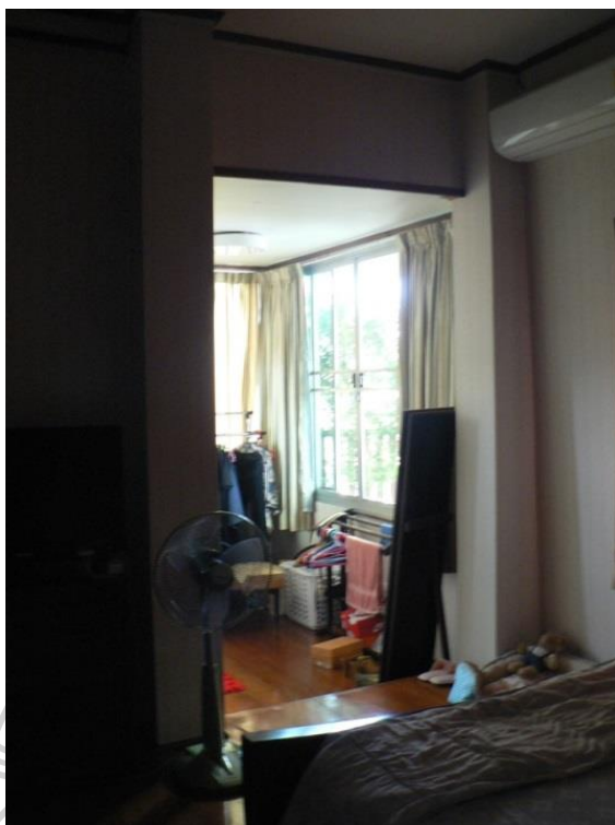
ภาพที่ 111 เสาคสล.ที่เป็นตำแหน่งของเสาฝ้าเดิม ในเรือนกรณีศึกษาที่ 6
