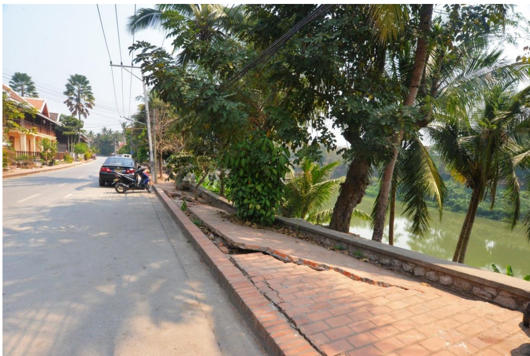
ภาพที่ 98: ผลกระทบจากภัยธรรมชาติที่มีต่อสิ่งปลูกสร้างริมฝั่งน้ำคานปีค.ศ.2017
