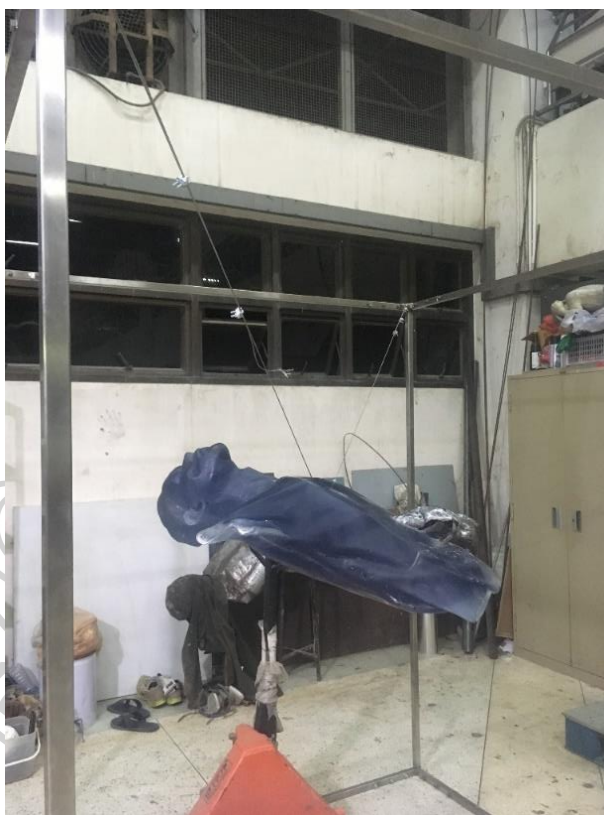
ภาพที่ 52 ขั้นตอนการติดตั้งชิ้นงานกับ โครงสร้างเหล็ก
