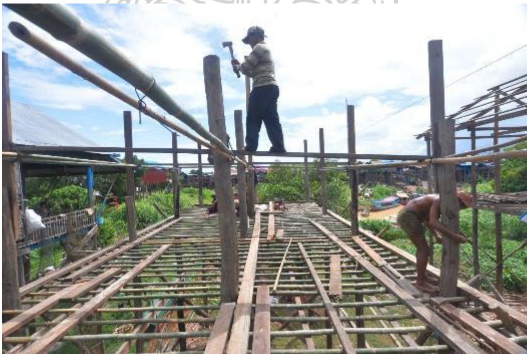
รูปที่ 48 การติดตั้งโครงสร้างพื้นเรือน เพื่อให้มีพื้นที่สำหรับการทำงานด้านบนโดยสะดวก
