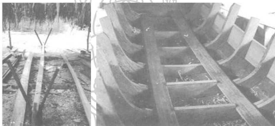
ภาพที่ 5.25 ภาพแสดงการวางโครงเรือ : ตั้งกระดุกง
