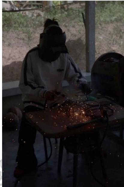
รูปภาพที่ 18 ภาพขั้นตอนสร้างสรรค์ผลงานวิทยานิพนธ์ชั้นที่1 ชั้นโครงเหล็กตามแบบร่าง 2 มิติ ที่มา : ถ่ายโดยโสภิตา บรรยงคิด. 2562
