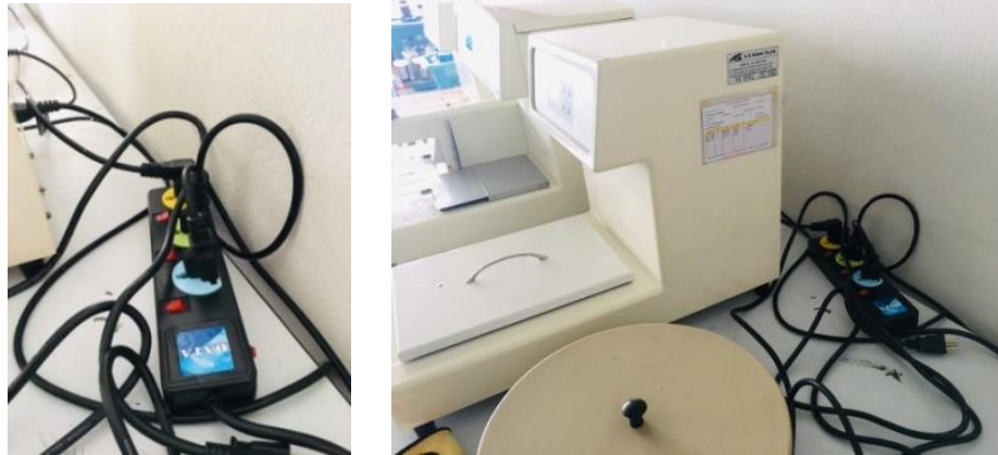
ก) ใช้อุปกรณ์สายไฟฟ้า เต้ารับ เต้าเสียบ ที่ยังไม่ได้มาตรฐาน และมีการต่อสายพ่วงซึ่งใช้งานเกิน 8 ชม.
