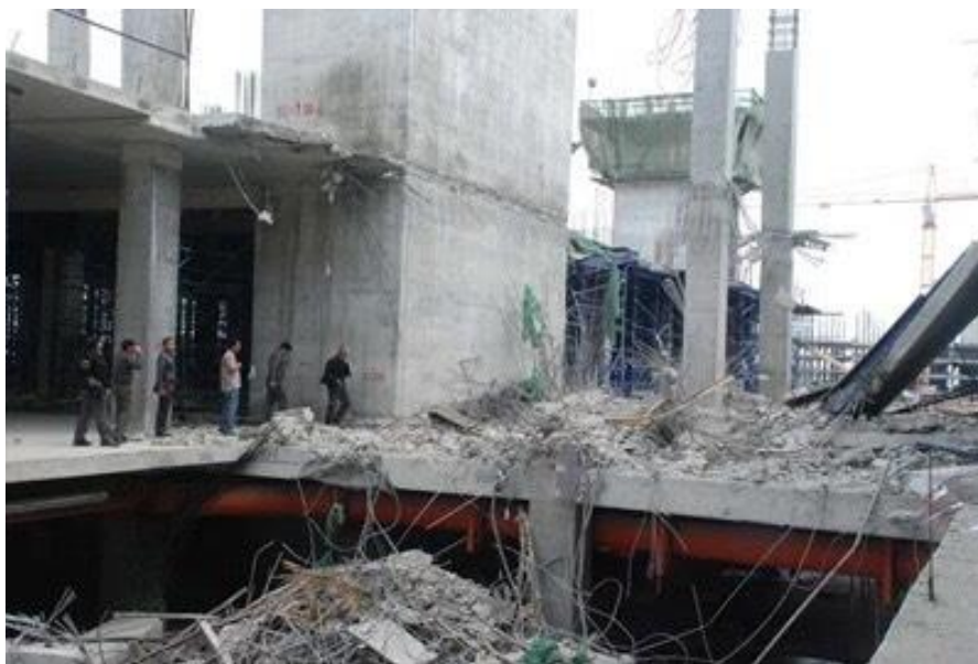
รูปภาพที่ 58 อุบัติเหตุแผ่นดินไหวถล่มทับคนงานเสียชีวิต โครงการโรงพยาบาลรามธิบดี
