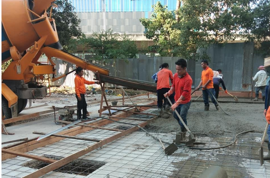
รูปภาพที่ 82 การทำงานที่ไม่ได้สวมใส่อุปกรณ์ป้องกันภัยส่วนบุคคล
