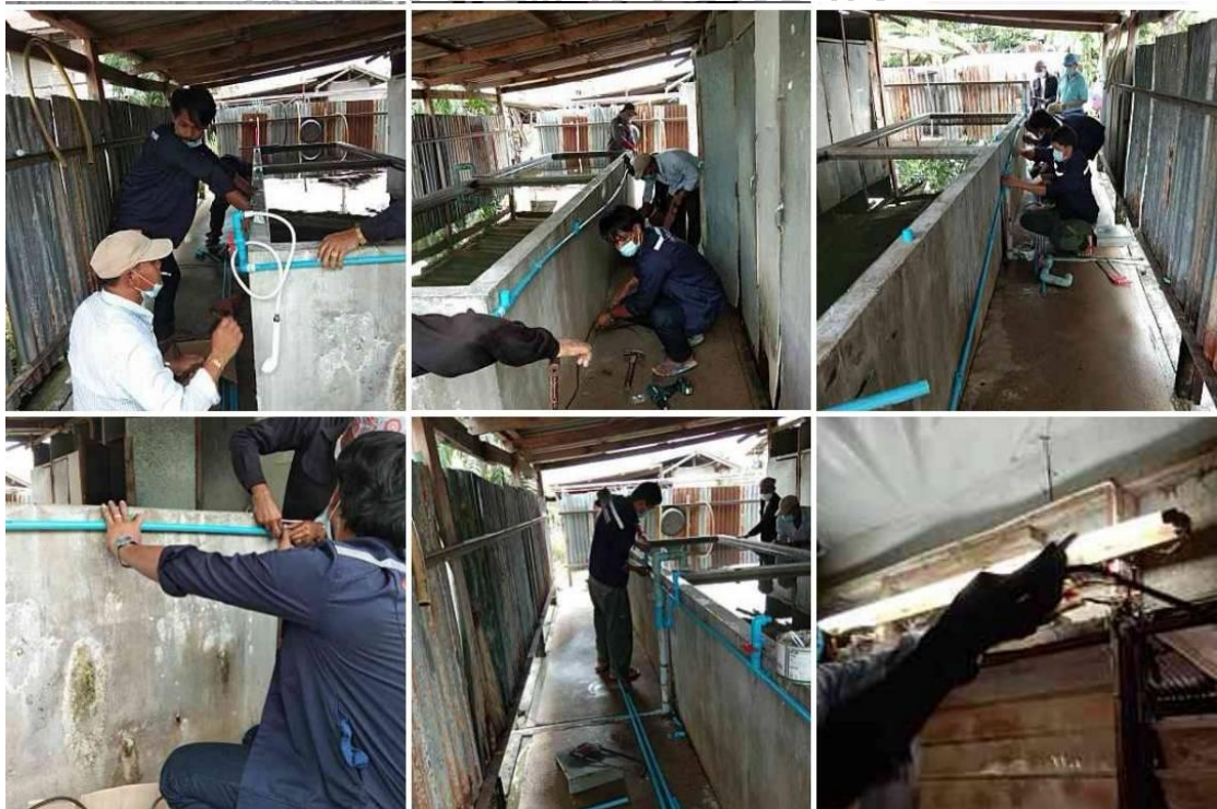
รูปภาพที่ 101 ปรับปรุงห้องน้ำพนักงานติดตั้งฝักบัว จากเดิมเป็นอ่างอาบน้ำรวม
