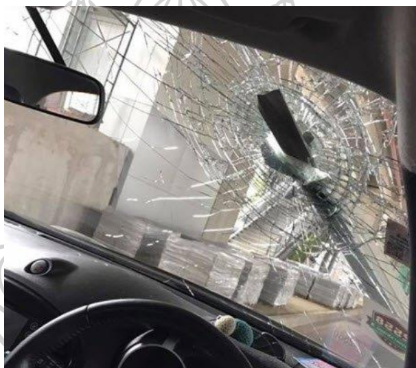
รูปภาพที่ 56 อุบัติเหตุไม้ฉาบปูนคนงาน รถไฟฟ้าสายสีแดง หล่นใส่รถประชาชน
