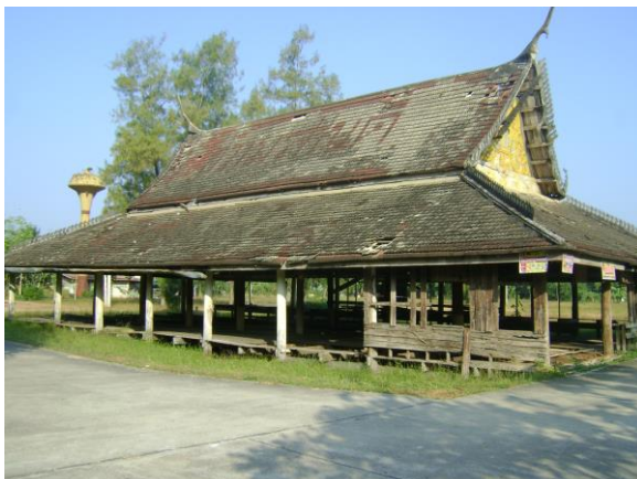
ศาลาการเปรียญ กว้าง 12 เมตร ยาว 32 เมตร เป็นอาคารไม้ทั้งหลัง สร้าง เมื่อ พ.ศ. 2502 ในสมัยหลวงพ่อคุ้ม เป็นเจ้าอาวาส ปัจจุบัน ชำรุดทรุดโทรม เพราะถูกปลวกกินและกาลเวลา
