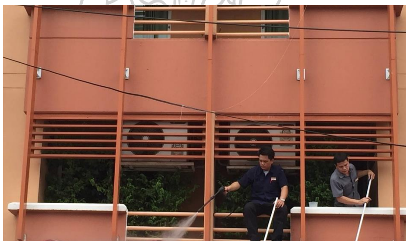
รูปที่ 49 คอมเพรสเซอร์ (Compressor) เครื่องปรับอากาศติดตั้งที่ระเบียบแยกห้องต่อห้อง แหล่งที่มา : www.facebook.com/thepatrahotel
