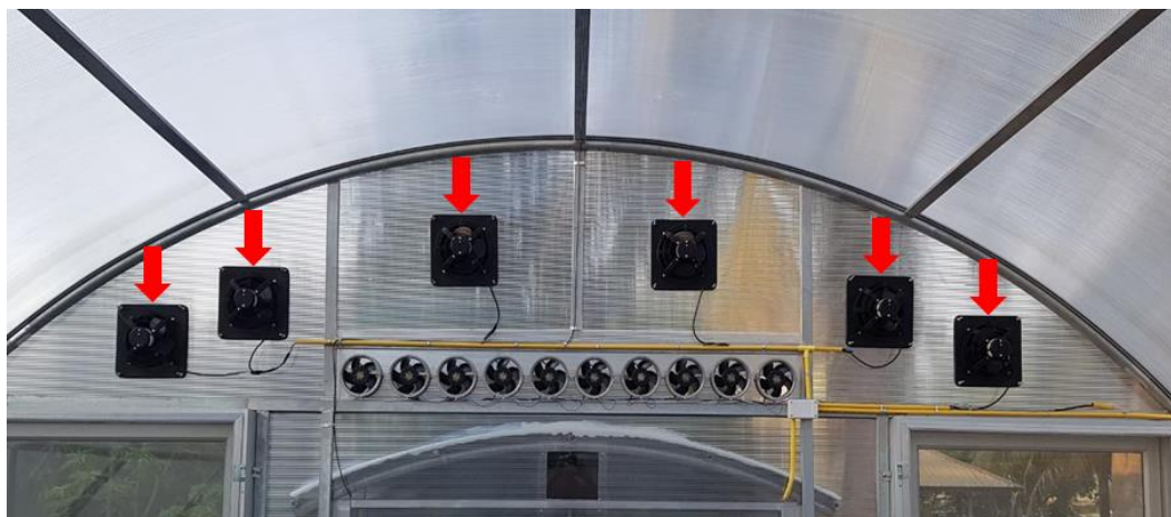
รูปที่ 50 พัดลมระบายอากาศชนิดใช้กระแสไฟฟ้ากระแสสลับ
