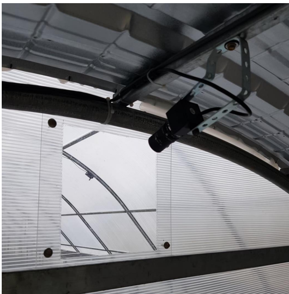
รูปที่ 48 การติดตั้งกล้องถ่ายภาพสำหรับถ่ายภาพนิ่งภายในเครื่องอบแห้ง
