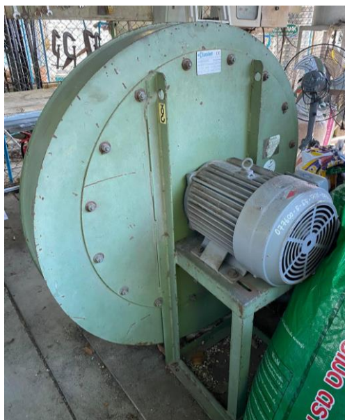
รูปที่ 3.5 พัดลมปฐมภูมิ (Primary blower)
