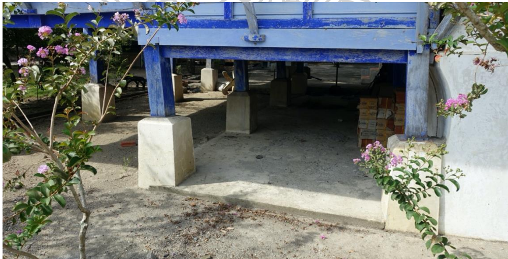
ภาพที่ ๒๐๗ เทคนิคการพอกและตั้งเสาเรือนบนดินเสาก่อปูน ตัวอย่างในกุฏิวัดท้ายยอ จังหวัดสงขลา
