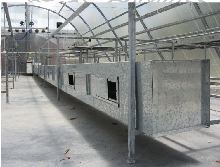
รูปที่ 3.14 ท่อสำหรับกระจายลมร้อน
