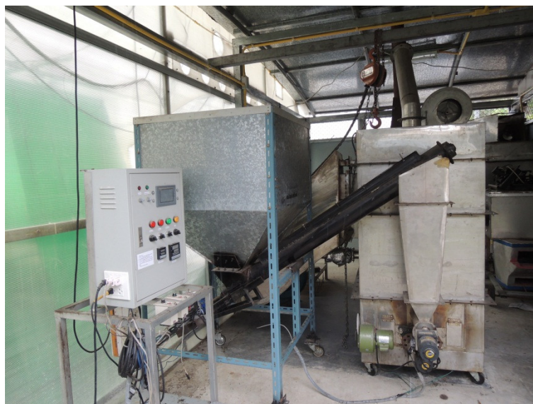
รูปที่ A4.1 การตรวจสอบความพร้อมของระบบทำอากาศร้อน
