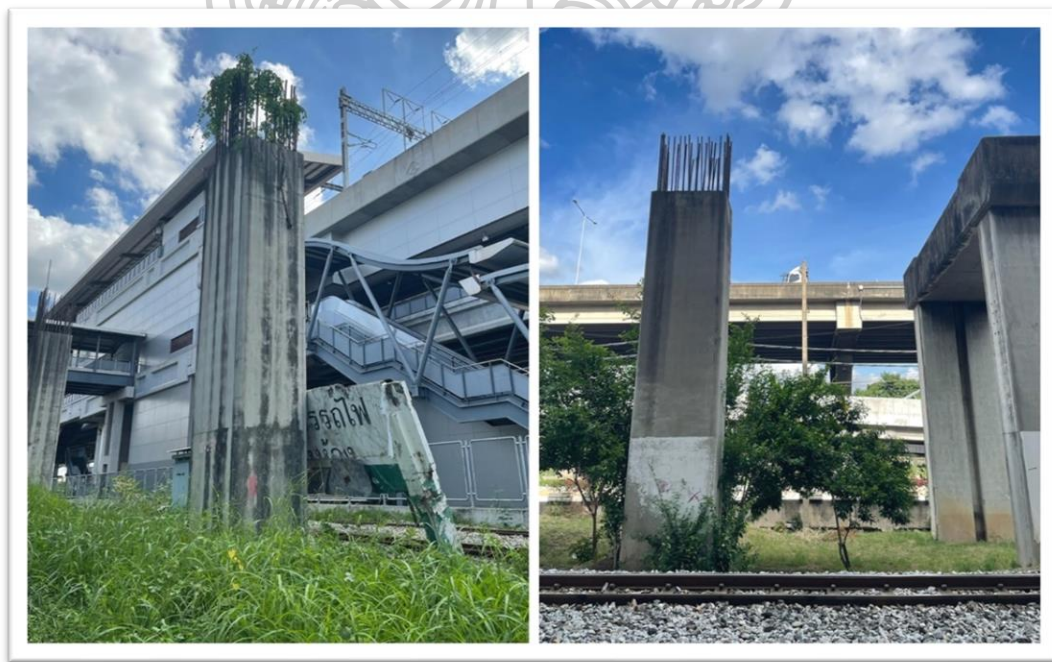
ภาพที่ 10 ภาพเสาตอม่อโครงการทางยกระดับไฮโปเวลต์ ถ่ายโดยผู้วิจัยสร้างสรรค์สร้างสรรค์
