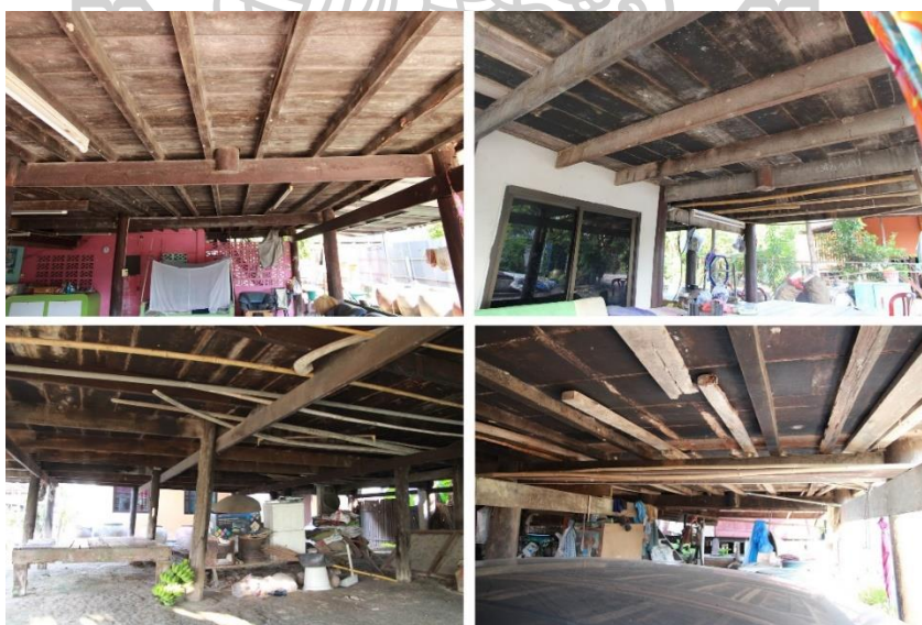
ภาพที่ 156 ลักษณะโครงสร้างพื้นไม้ ตงไม้ และคานไม้ของเรือนกรณีศึกษา
