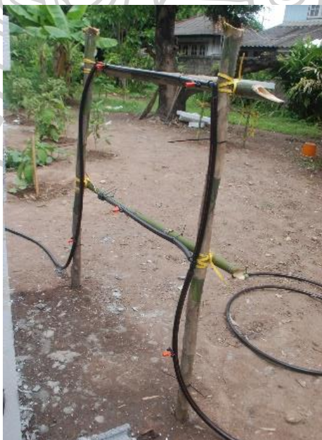
รูปที่ 183 แสดงการติดตั้งระบบฉีดน้ำแบบ Spray จำนวน 5 จุด
