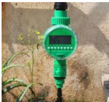
รูปที่ 184 แสดงการติดตั้งระบบตั้งเวลาเปิด-ปิดน้ำ
