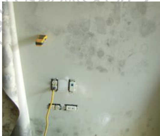
รูปที่ 10 แสดงลักษณะของผนังที่ไม่ได้มีการใช้วัสดุอุดปิดอย่างเหมาะสม
