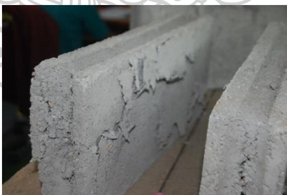
รูปที่ 153 แสดงลักษณะของคอนกรีตบล็อกที่แตกร้าวหลังจากกดด้วยเครื่องอัดไฮดรอลิก Compressive Strength
