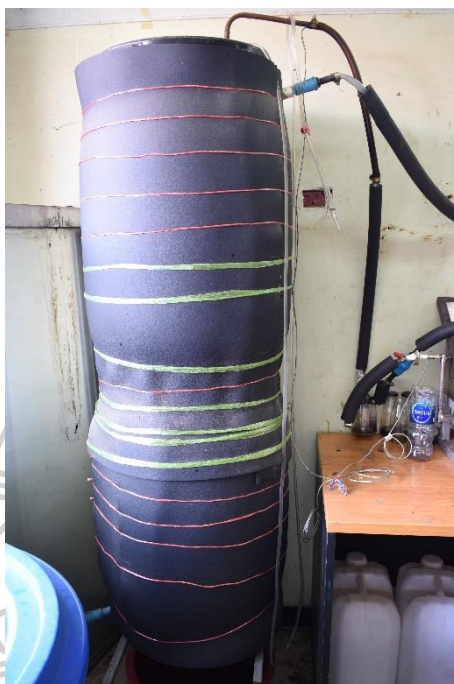
รูปที่ 3.6 เครื่องควบแน่น
