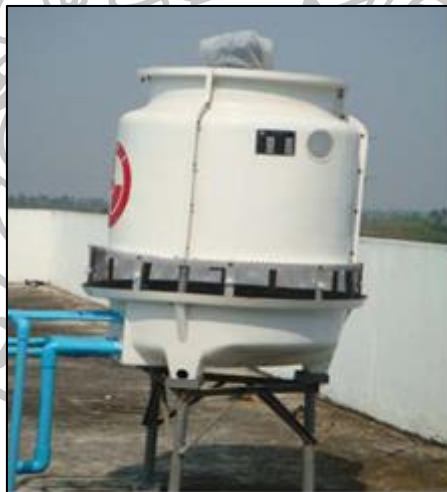
รูปที่ 3.4 หอฝึ่งเย็น
