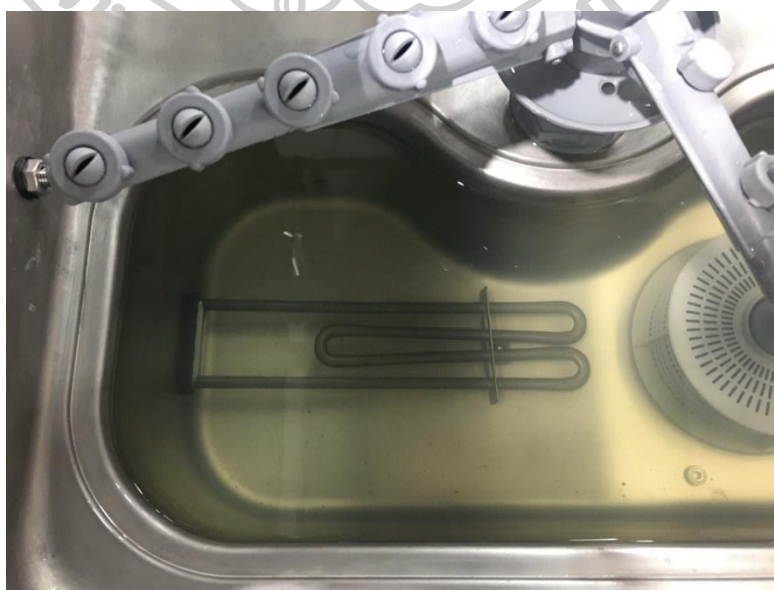
ภาพที่ 24 Heater Tank
