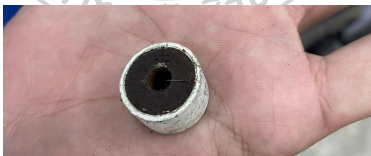
ภาพที่ 22 แม่เหล็กสวิตช์ประตูเสื่อมสภาพ
