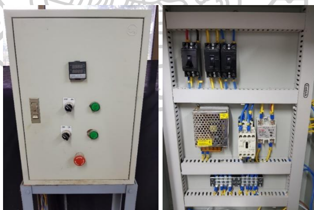
รูปที่ 23 ตู้ควบคุมการทำงานของเครื่อง RJS ภายนอก(ซ้าย) ภายใน(ขวา)
