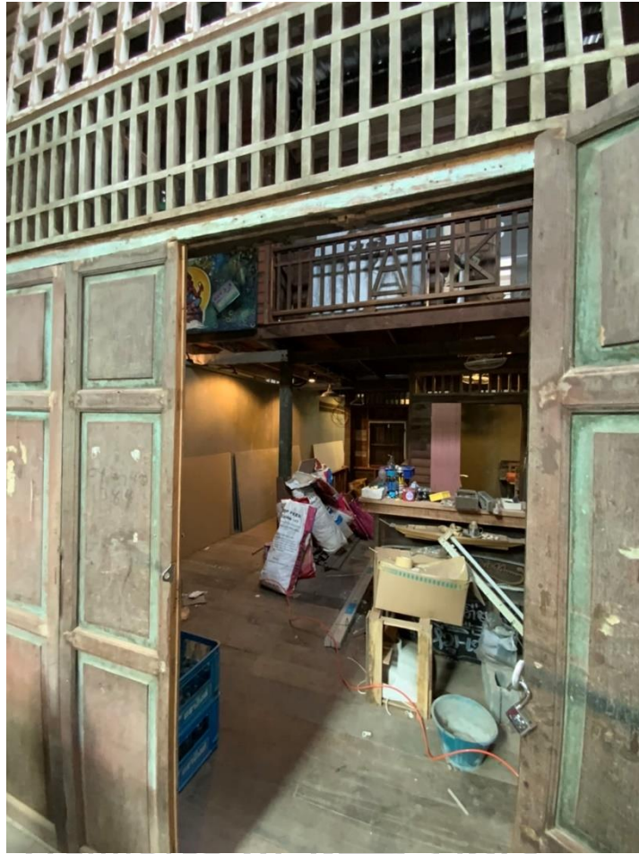
ภาพที่ 96 ร้านสเต็กเซ็ทแอนด์เซฟ ที่กำลังปรับปรุงพื้นที่การใช้งานส่วนเรือนแถว ที่มา : ผู้วิจัย
