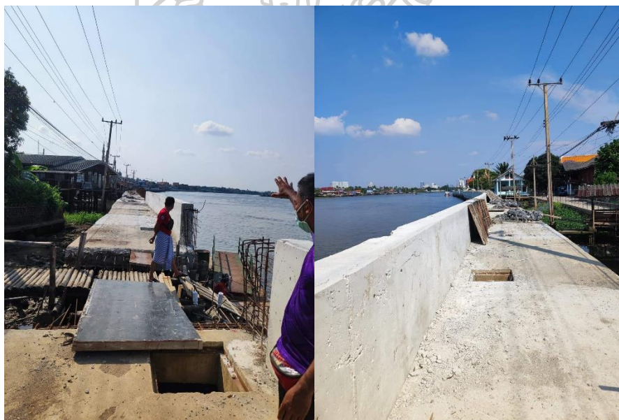
ภาพที่ 42 โครงการถนนเลียบริมน้ำเจ้าพระยาอยู่ในช่วงก่อสร้าง
