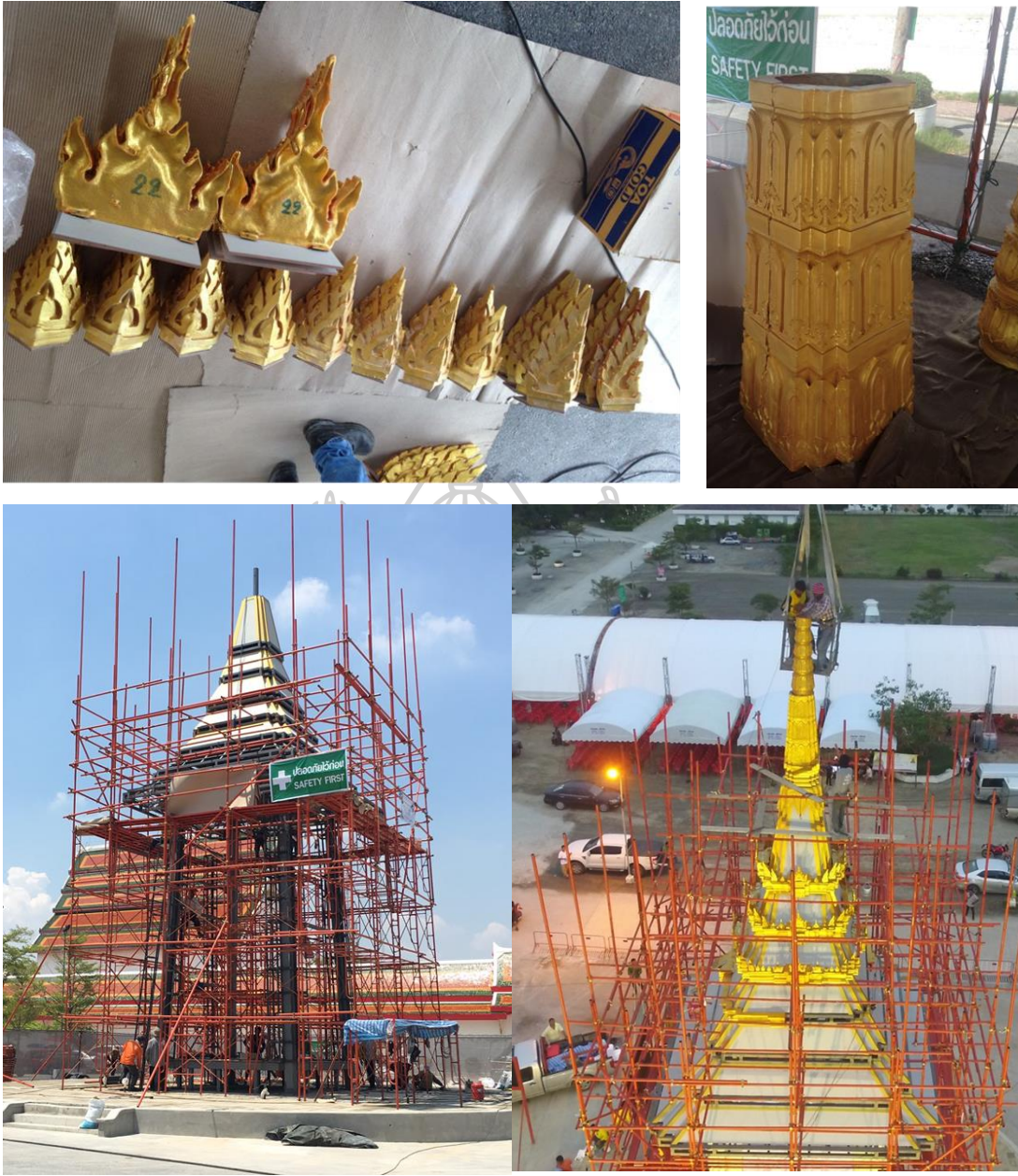
ภาพที่ 79 ขั้นตอนที่ 4 งานติดตั้งบัวหล่อเรซิน (พ่นสีทอง)
