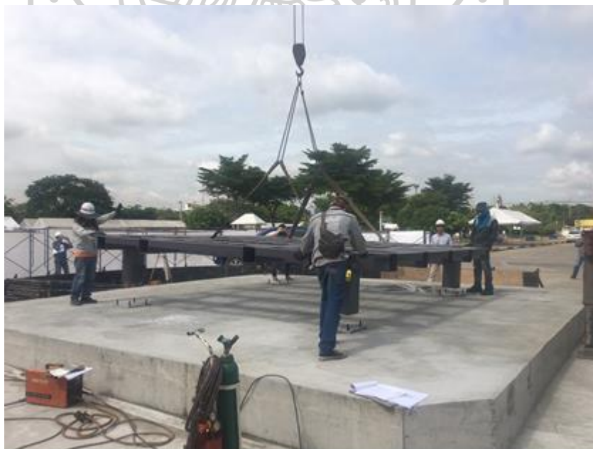
ภาพที่ 62 แสดงงานฐานและงานติดตั้งโครงสร้างเหล็ก
