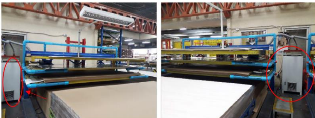
รูปที่ 3.13 หลังการติดตั้งเครื่องฟอกอากาศในพื้นที่และระบบท่อดูด
