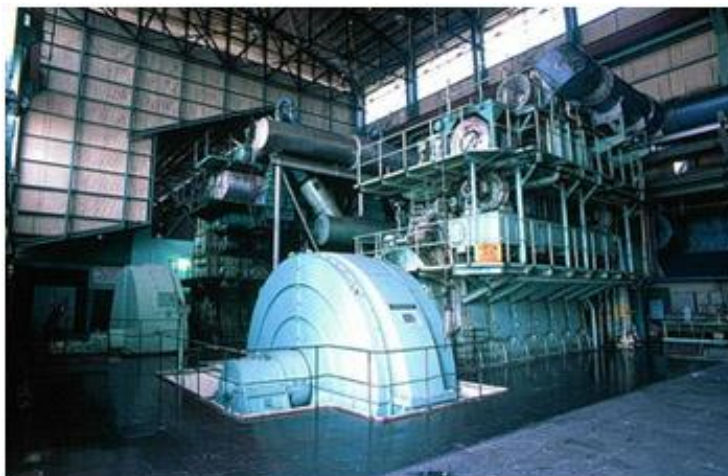
ภาพที่ 8 โรงไฟฟ้าดีเซล [6]
