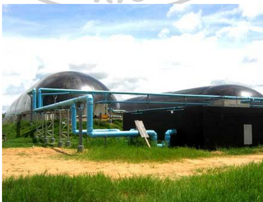
ภาพที่ 13 โรงไฟฟ้าก๊าซชีวภาพ [11]
