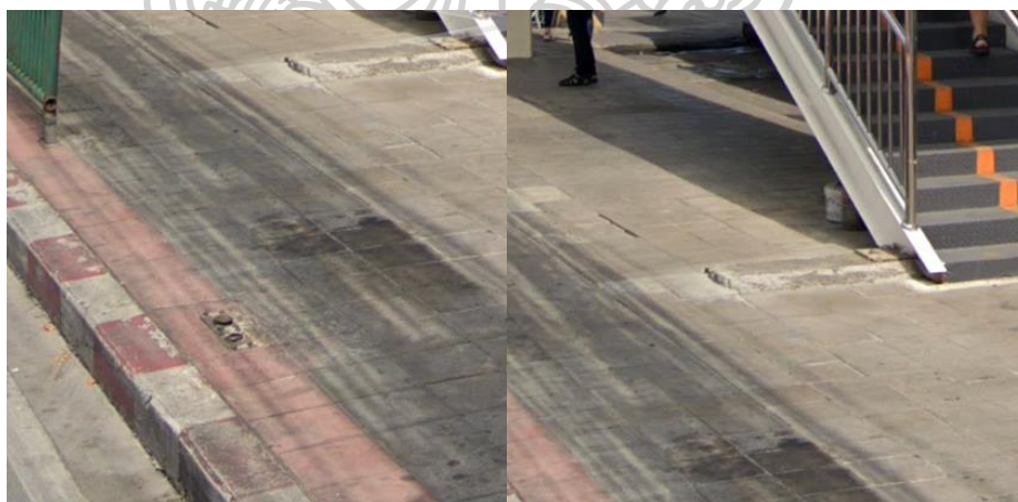
ภาพที่ 47 แสดงสภาพทางเท้าสถานีปุณณวิถี (ซ้าย) จากการสำรวจเมื่อ พฤษภาคม 2567
