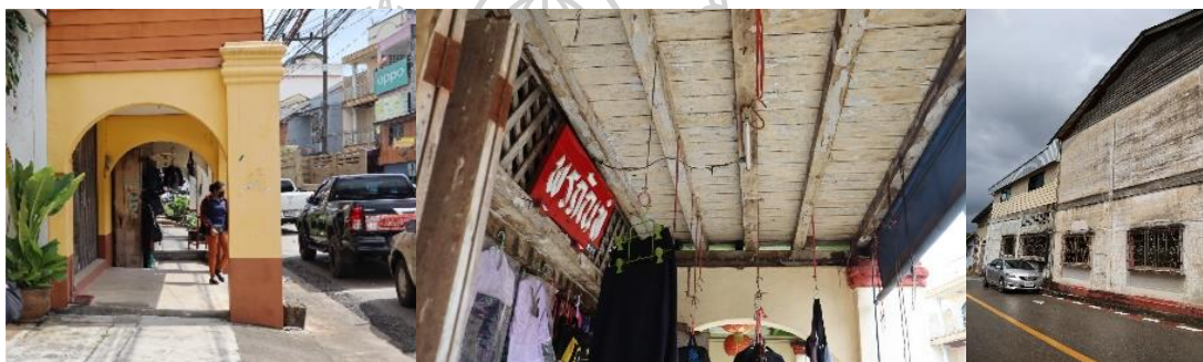
ภาพที่ 23 แสดงภาพถ่ายโครงสร้าง ผนังรับน้ำหนัก และผนังปูนหล่อ (ที่มาภาพถ่ายโดย : ผู้วิจัย)
