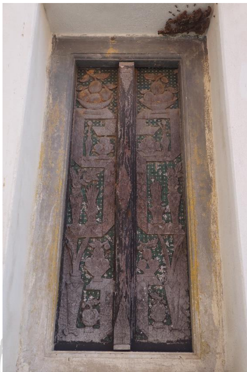
ภาพที่ 564 บานหน้าต่างวิหารพระพุทธบาท 4 รอย วัดพระพุทธบาท จังหวัดสระบุรี
