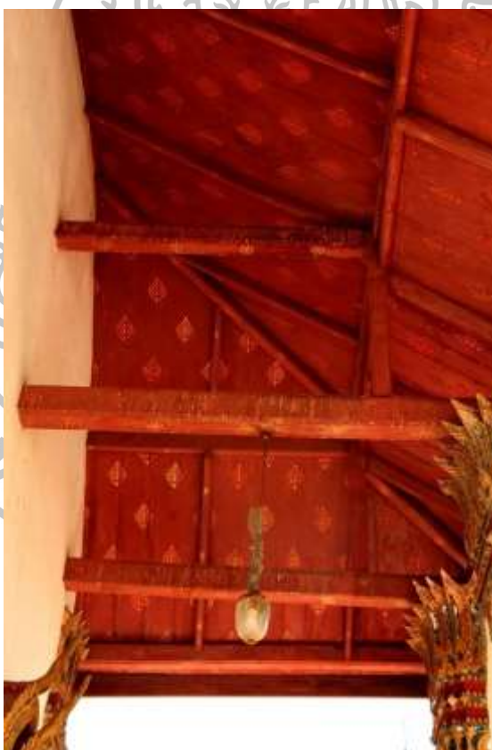
ภาพที่ 38 ภาพโครงสร้างของหลังคาเฉลียงพระอุโบสถ
