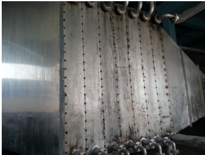
ภาพที่ 3.7 ชุดคอยล์ไอน้ำ (Steam coil)
