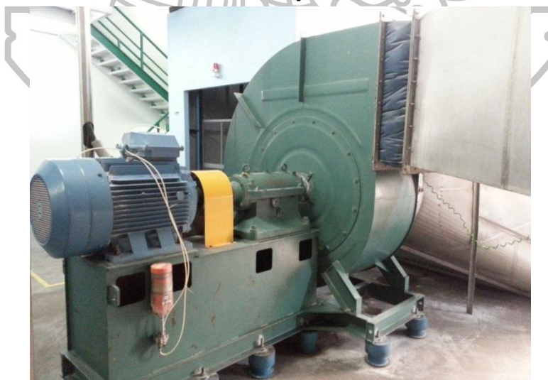
ภาพที่ 3.6 โบลเวอร์ซาเข้า (Inlet Blower)
