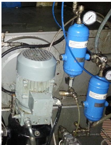
ภาพที่ 3.29 ส่วนประกอบย่อยของชุด Lubrication Plant
